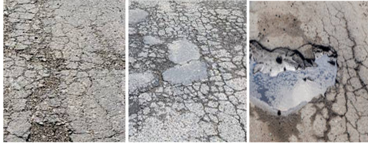
Şekil 2. Kaplamada meydana gelen bozulmalar [12].
